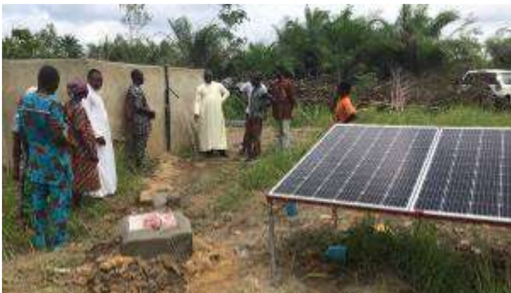
Photo 19 : Ouvrage hydro-agricole muni de champ solaire réalisé pour l'irrigation du périmètre rizicole de Dovi-Klobo, Diocèse d'Abomey, 2019
